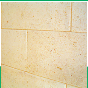
Brennraum mörtellos gefügt, keine Rissbildung firing chamber gaped mortar free, no cracks
